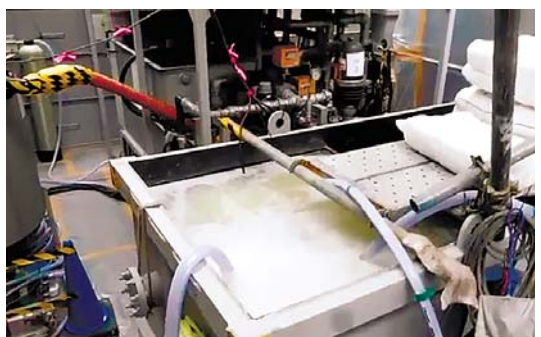
VAWM工法の要となる水処理システム
