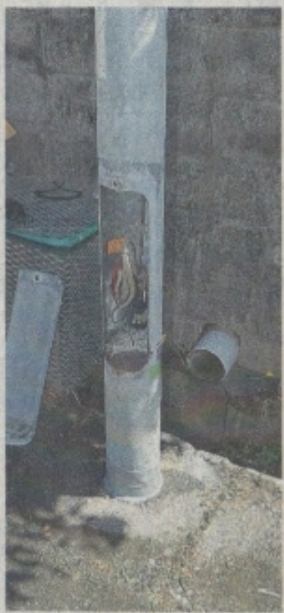
①鋼管柱に接着剤を塗ったアラミドシートを挿入し、内部を補強していく②修繕を受けた後の鋼管柱。13日、うるま市昆布
